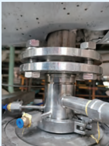
图 9 一次风粉管取样装置
